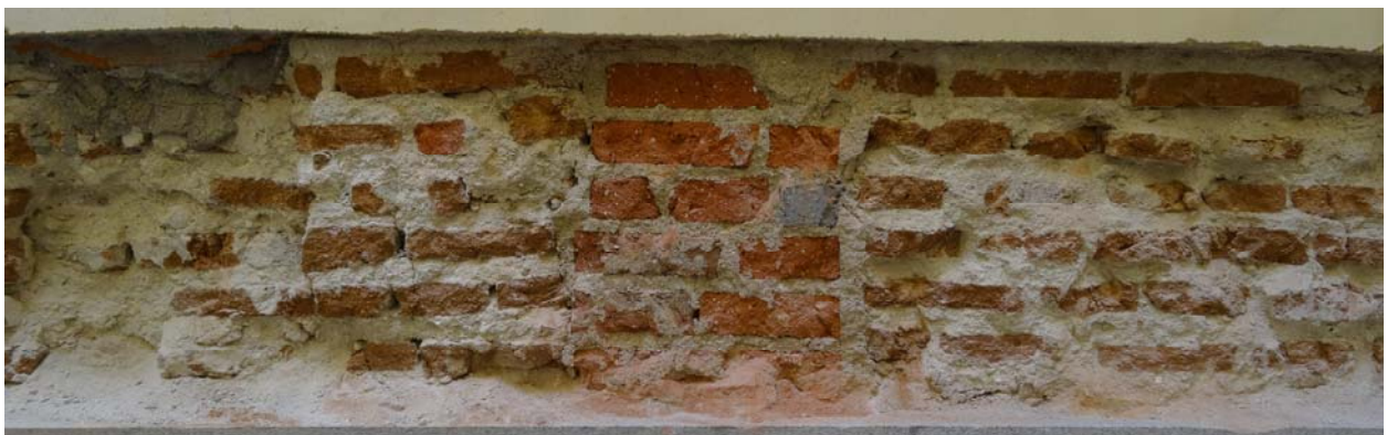
Detalle de una cata con conformación heterogénea del paramento con diversidad de fábricas de ladrillos
