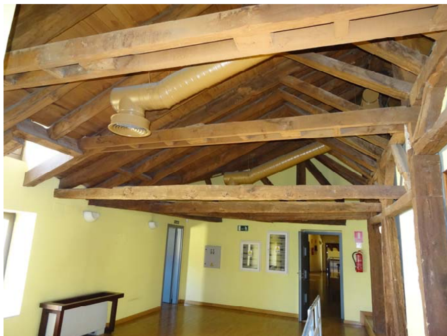
Vista actual de la estructura de soporte de la cubierta a base de vigas de madera
